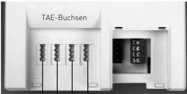
TK-Anlage mit geöffnetem Anschlussfeld
